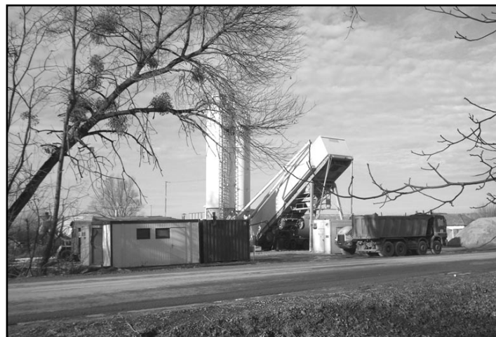
Ideiglenes betonüzem Tivadarban
