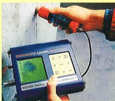
CANIN a betonba ágyazott vas korróziójának feltérképezéséhez
