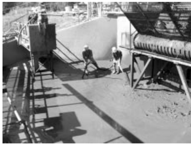
6. ábra: Az első bekeverő medence és a szivattyúval végzett zagyszívás
