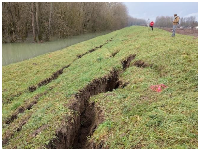
3. ábra. Talajfolyósodás miatt bekövetkező talajszétcsúszás a Száva folyó töltésén (Tomac et al. 2021)
