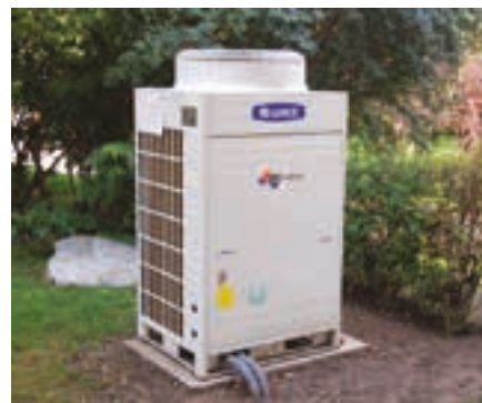
A községháza klímaberendezéseinek kültéri egysége
