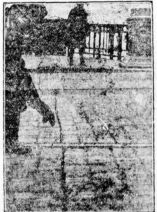
A hideg következtében megrepedt breslauer Wilhelm-híd
