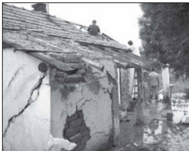
A Batthyány utcában egy vályog falú ház lebontását is el kellett rendelni életveszélyessége miatt
