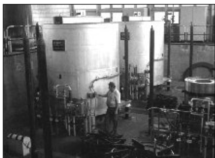
■ 11. ábra. Ebner védőgázás fényeslágyító hőkezelő berendezés
