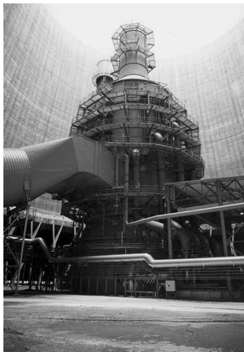
7. ábra: Kén-dioxid leválasztó abszorber a hűtőtorony közepén
