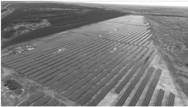
14. ábra: Az épülő bükkábrányi naperőmű
