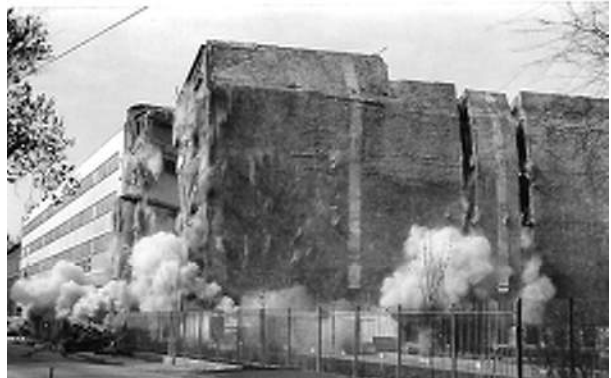
2. kép: Épületrobbantás a Siemens gyár irodája mellett
