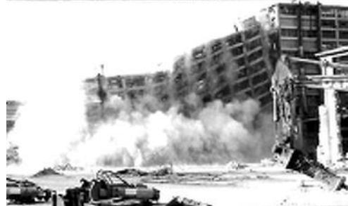
4. kép: A Ganz Villamossági Művek „F” épületének robbantása
