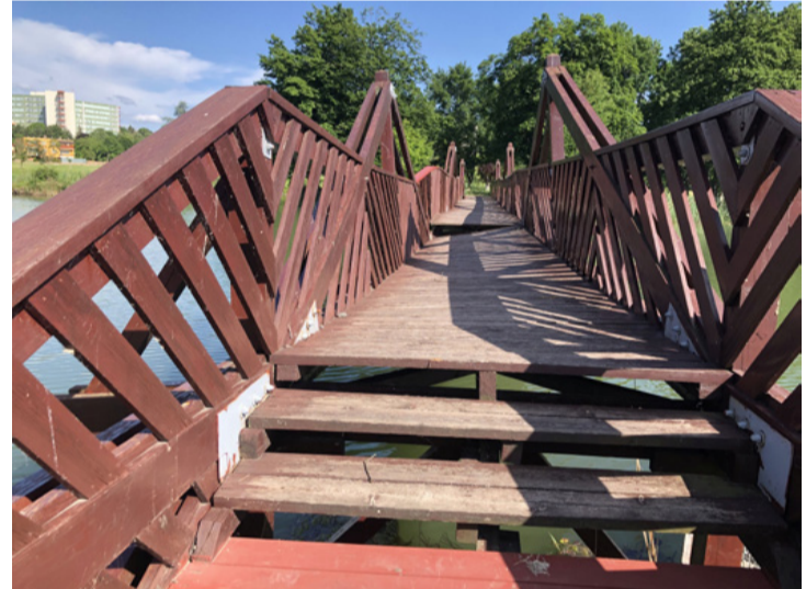
A szigetre vezető, felújításra már nem alkalmas híd (Fotó: Futó)
