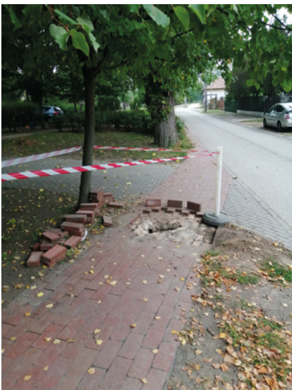
Az Erdei kápolnánál a megsüllyedt járda adott feladatot
