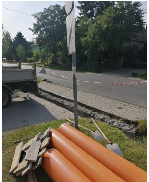
Csapadékvíznyelő rácsok helyett csövek több utcában
