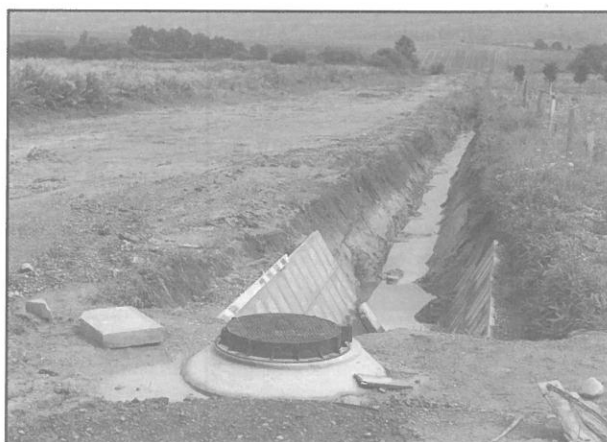
A Báthory utcától a csatorna nyitott árokban folytatódik
