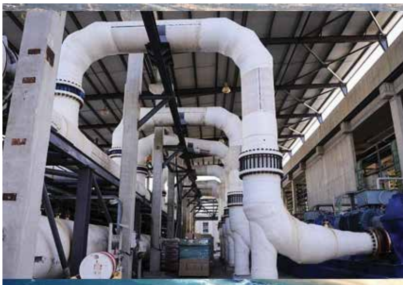
A Sorek 1 sótalánító
