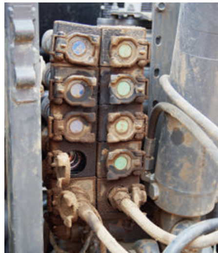
Az öt pár kihelyezett csatlakozó bőven elegendő a munkaeszközök működtetéséhez
