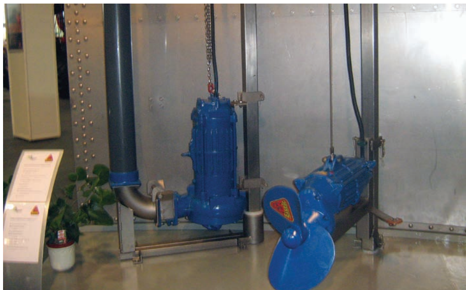
2. kép. Beépített homogenizáló berendezések
