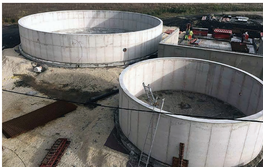
A Biogáz Unió Zrt. építette Magyarországon a legtöbb biogázüzemet
