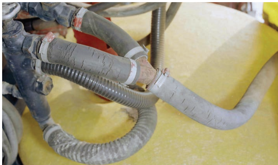
Ha nem védjük megfelelően az időjárás hatásaitól a permetezőt, akkor a folyadékszállító tömlőrendszere végzetesen károsodhat
