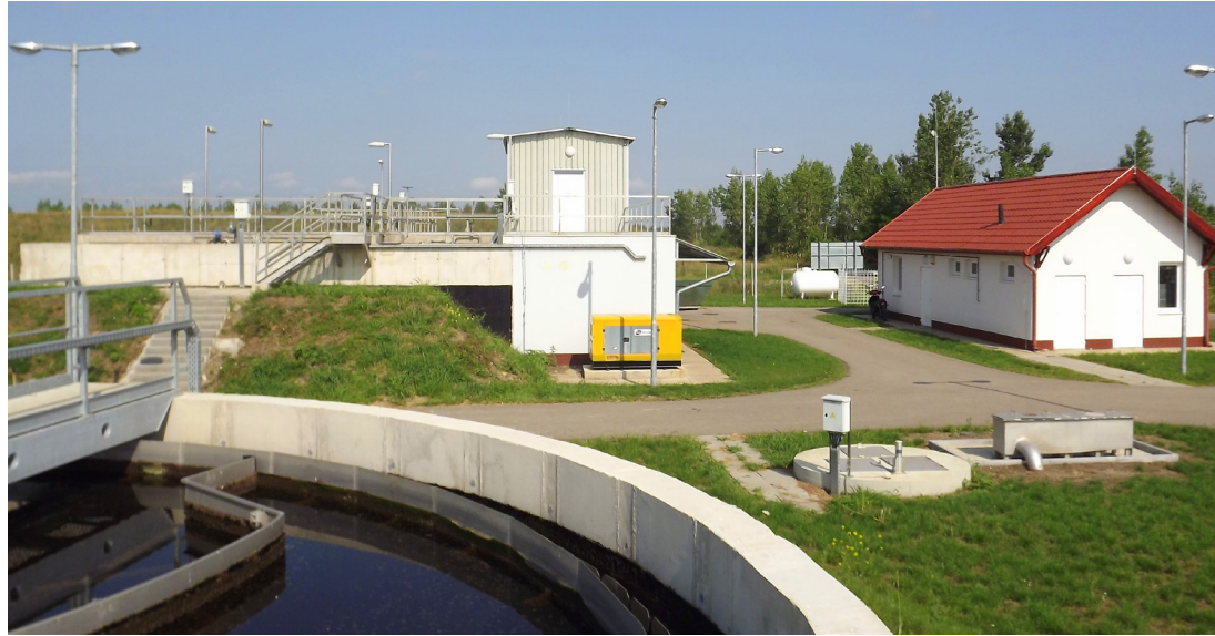
KEOP-programban épült szennyvíztelep a Taktaközben
