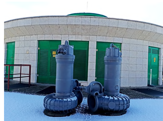
Ferencváros új szivattyúk, 2010
