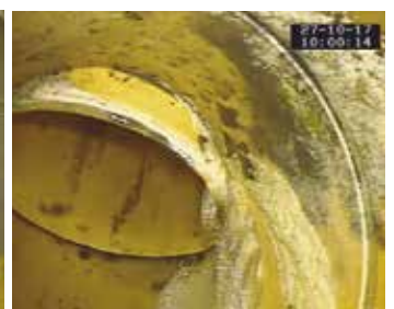
8. kép: Intenzív vízbetörés törött bekötővezeték mellett
