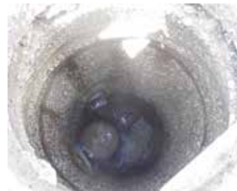
6. kép: Korrodált beton tisztítóakna - javítás előtt
