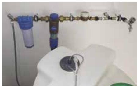
4. ábra: A vezetékes víz előkezelése
