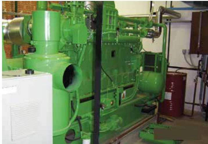
A 2003-ban, Veszprémben üzembe helyezett Jenbacher J208 típusú gázmotor
