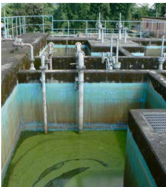
Üzemen kívüli levegőztető műtárgy egy nagyobb víztisztító telepen
