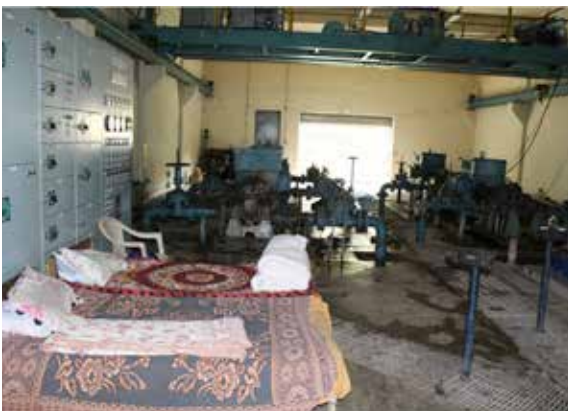
Ebben a szivattyúházban szinte együtt élnek a szivattyúkkal
