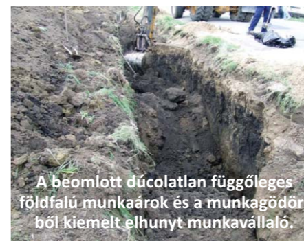
A beomlott dúcolatlan függőleges földfalú munkaárok és a munkagödörből kiemelt elhunyt munkavállaló.
