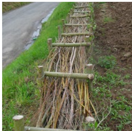
5. kép: Vízvisszatartó és hordalékfelfogó létesítmények
