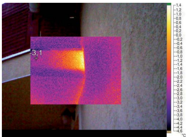
Építészeti felülvizsgálat: szigetetlen erkélylemez
