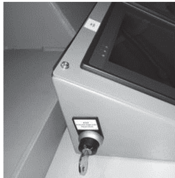
7. ábra. A fékpadok indítását engedélyező kulcsos kapcsoló.
