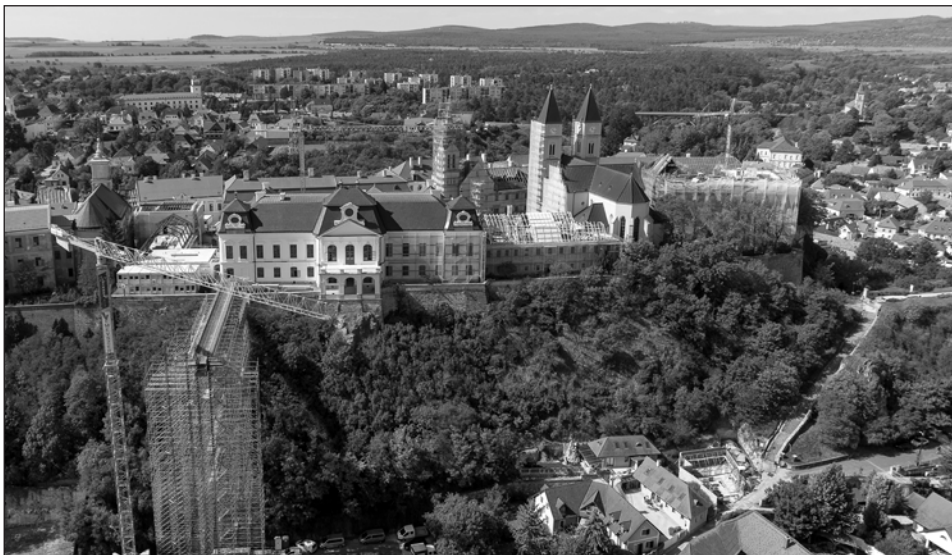
A közút tehermentesítésére létrejött térállványrendszer az Érseki Palota előtt. Fotó: Nagy Lajos, ÉpíTech
