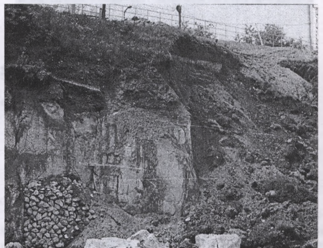
7. ábra. Pincesor szakadása partfal omlással, - pincetömedé- késsel. Eger, Arnyékszala u.
