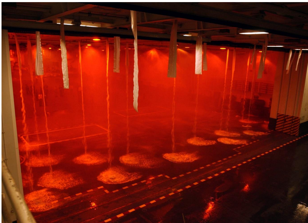
2. kép A hangárfedélzet habsprinkler-rendszere működés közben [6]
