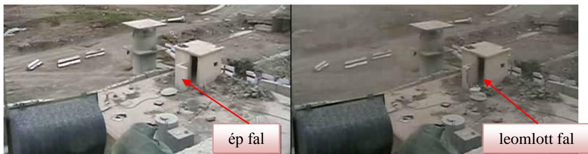
28. ábra Támaszponti épület előfalának leomlása a robbanás következtében - Irak
