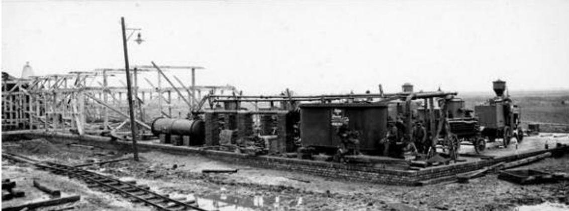
30. ábra A léghajóbázis gázgyára építés közben. Jól látható, hogy két tábori berendezést helyeztek el benne, melyeket tartályokkal egészítettek ki
