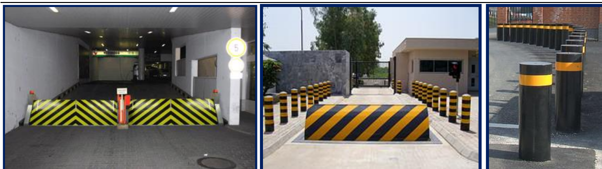
13. ábra Road-Blocker az épület bejáratánál[32]
