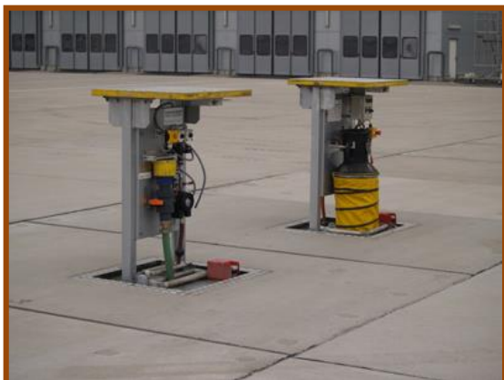
24. ábra A föld alá telepített kiszolgáló rendszerek csatlakozói[23]
