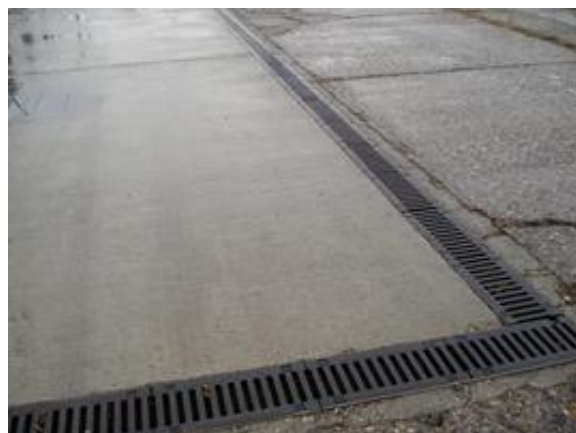
5. ábra Vízzáró réteggel bevont érkezési terület a gyűjtő csatornával [fotó: Szabó Zsolt]
