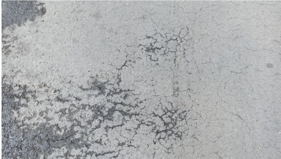
11. ábra: Termikus repedések a kopórétegen.
