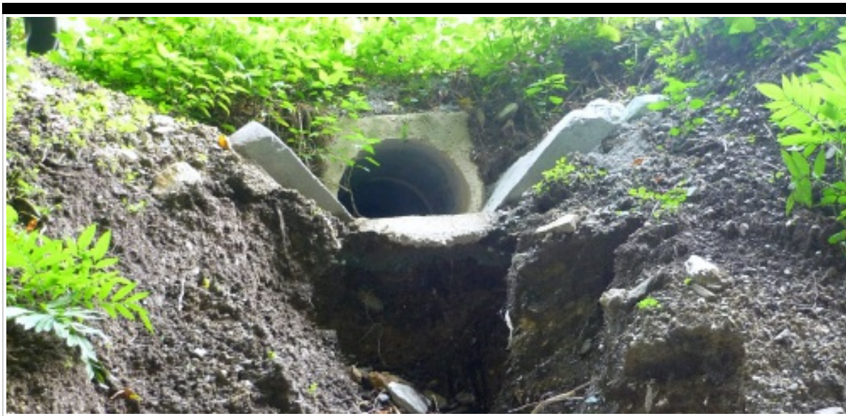
6. ábra Erózió a csőáteresztő kifolyási pontjánál
