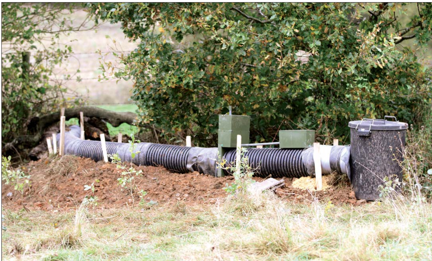
Múktorék csapda telepítés közben
