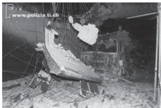
3. ábra Gotthard alagút betonfelületének réteges leválása [10] Fig. 3. Gotthard tunnel was spalling in the fire [10]
