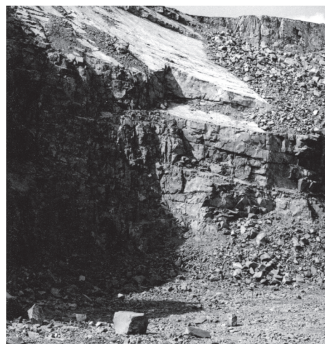
7. ábra A bányaudvar irányába lejtő törési sík az új bánya 306 mBf. szint, É-i bányafalán Fig. 7. Fracture plane sloping towards the mine yard at 306 meters above Baltic Sea level on the northern mine wall
