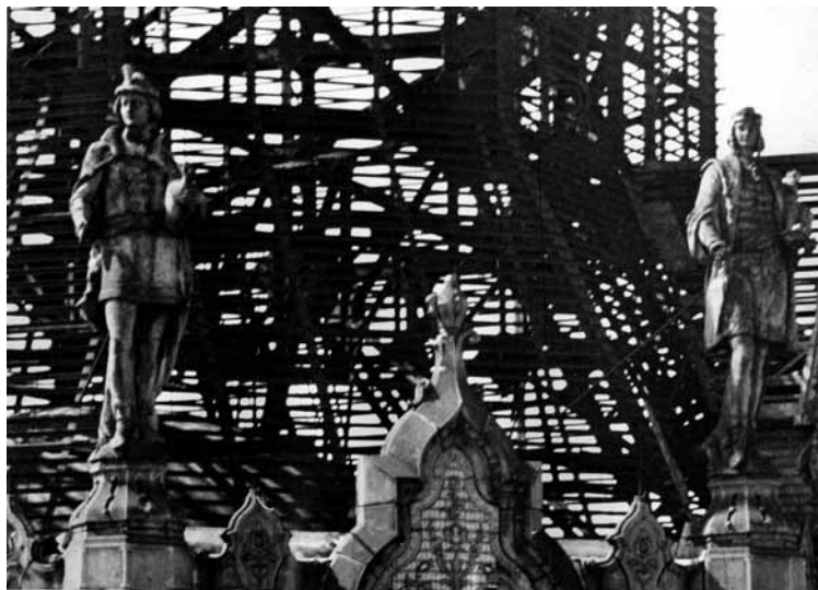
Az Iparművészeti Múzeum főkupolájának felújítása a kerámia műipart és a dekoratív szobrászatot szimbolizáló figurákkal, 1960-as évek
