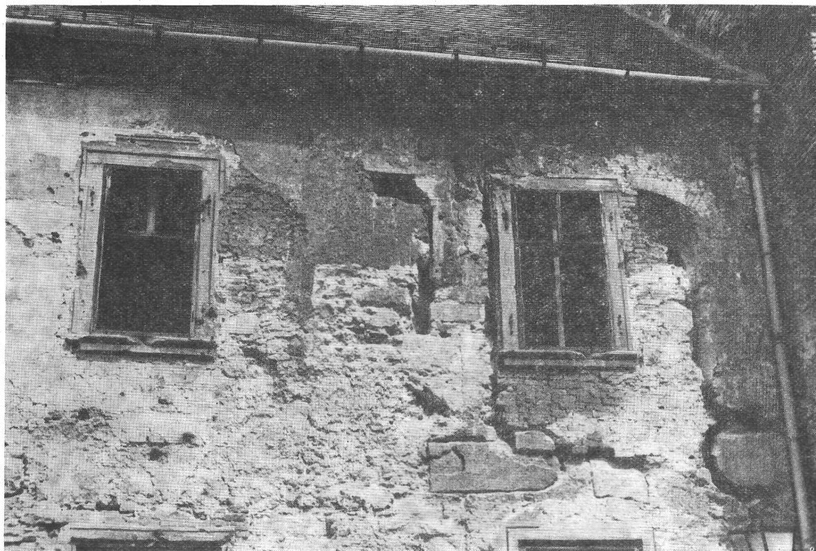
19. kép. Az Úri utcai homlokzat déli részének emeleti, posztgotikus erkélykonzol-maradványai a feltárás után a rájuk épített török átjáróajtó falával Zwei postgotisch angebrachte Konsolen am südlichen Ende der Fassade in der Úri-Gasse, mit der Mauer der auf sie gebauten türkischen Tür
