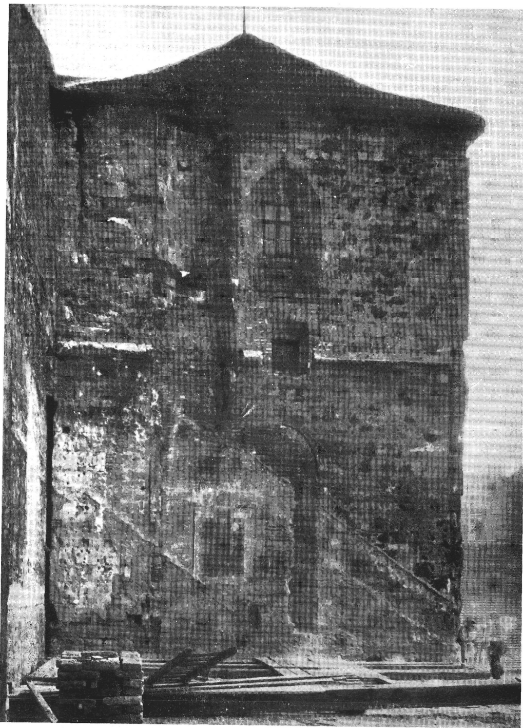
13. kép. — A torony keleti oldala. Jól megfigyelhető a csigalépcső és ajtókerete, az övpárkány, a gótikus ablak, melybe később négyzetes ablakot vágtak. Az alsó csúcsíves ablakot és a megsérült toronyfalakat barokk téglafalak egészítik ki. Az eredeti köveken jól láthatók a puskagolyó nyomok.
