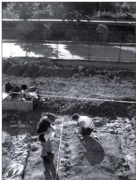
3. kép: Fűtőcsatornával ellátott épület részlete dokumentálás közben a BKV-HÉV sínek alatt Fig. 3: Segment of a building with a heating channel under the rails of the BKV-HÉV during documentation
