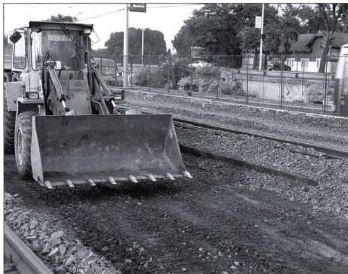
2. kép: Munkaterület a BKV-HÉV pálya mentén Fig. 2: Working area on the territory of the BKV-HÉV railroad
