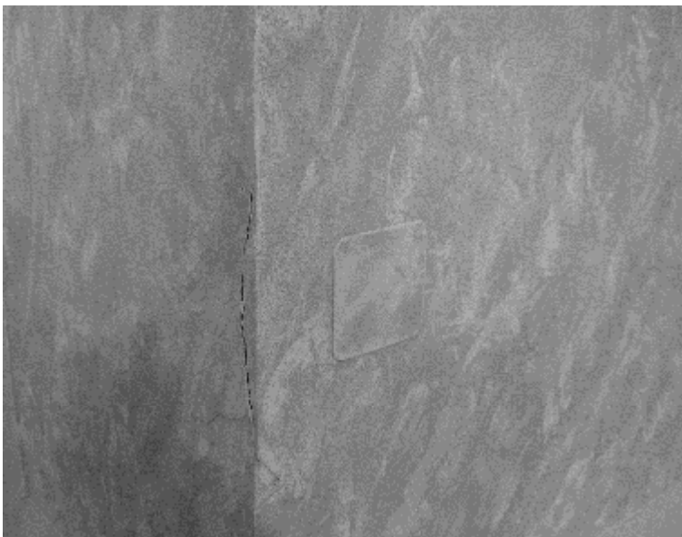
5. kép. Himod, igényes márványos festépek rekonstrukció a pilléreken. Az elektromos vezetékek vonalában mindenütt megrepedt a belső vakolat.
