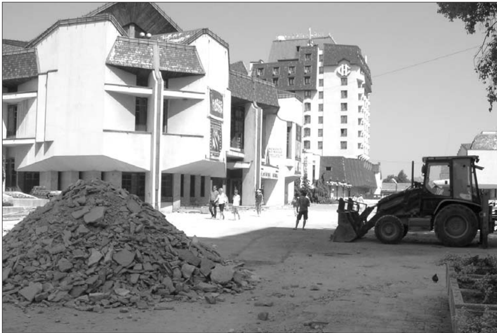
A marosvásárhelyi színházban és az előtte levő téren is évek óta tartanak az átépítési munkálatok
