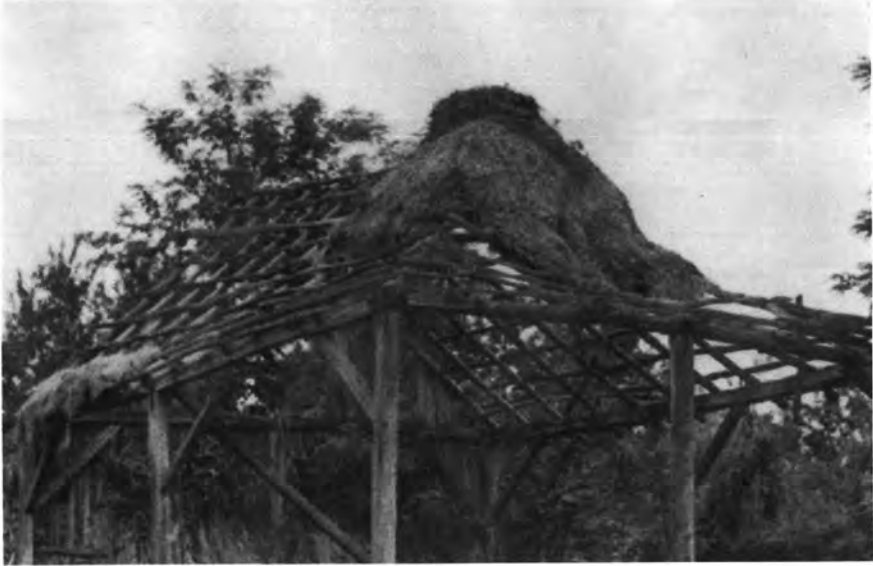
34.ábra: Céljavesztett mezőgazdasági épületrom gólyafészekkel Érszalacson K.L. felv. 1974.
