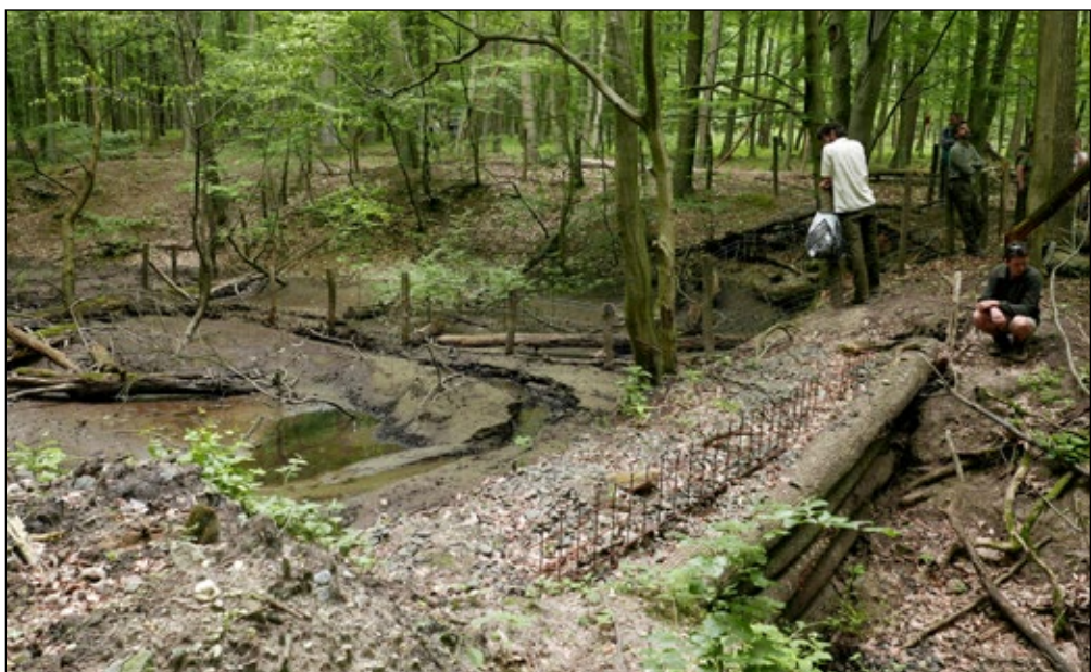
6. kép. Hordalékfogó gát a DINPI diósjenői projekt területén (Fotó: Frank Tamás)
