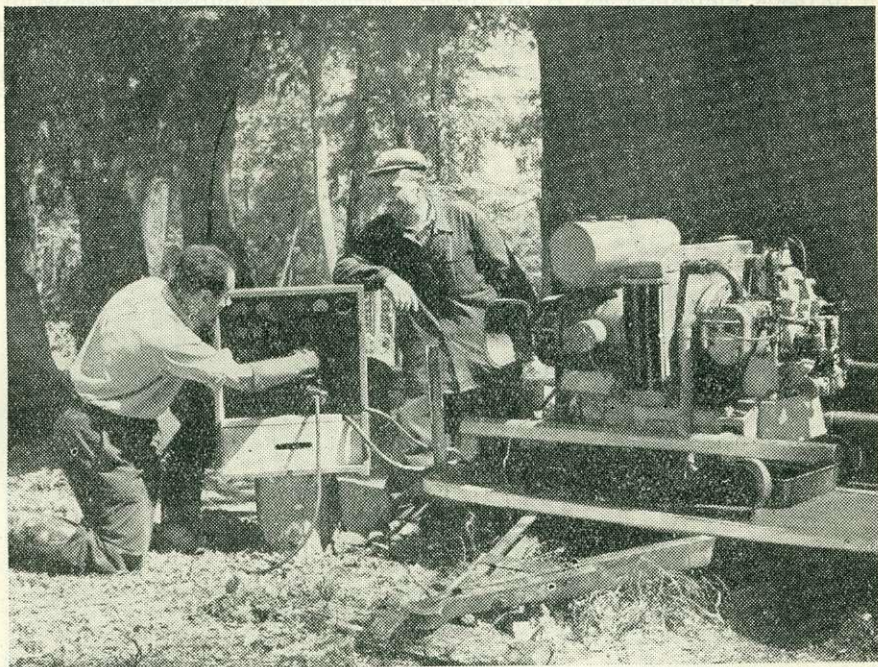
5 KVA-s áramfejlesztő gépcsoport a Keletbükkki erdőgazdaságban
